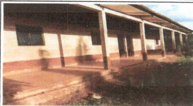
Foto 2: Se observa las puertas deterioradas
