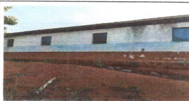
Foto 4: Se observa las ventanas con la pintura deterioradas
