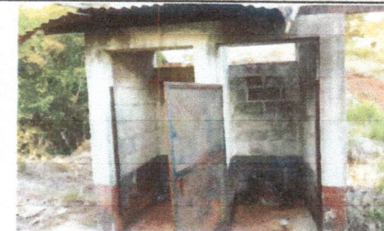
Foto 6: Se observa pintura deteriorada de los baños
