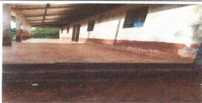
Foto 3: Se observa el corredor de la escuela en mal estado
