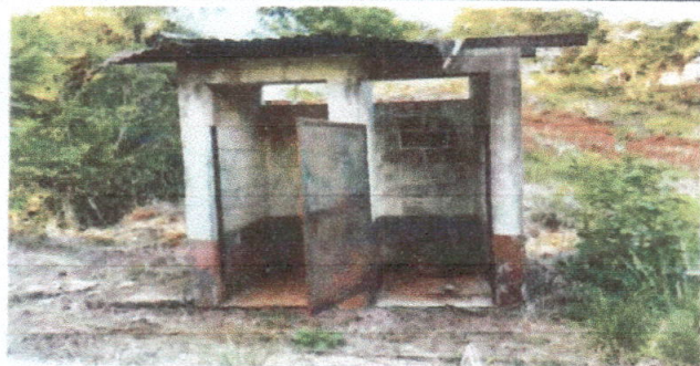
Foto 5: Se observa el techo de los baños de la escuela en mal estado
